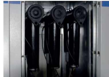
Rozdzielnica SF-6 z K480TB i 800PB-10SA-22N
